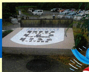
H29. 8 月 竜巻により入口看板倒壊
